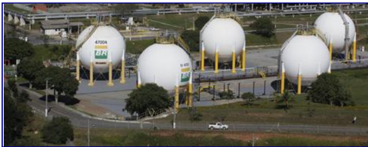
FIGURA 5.5.9-1: UNIDADE DE TRATAMENTO DE GÁS DE CABIÚNAS FONTE: PETROBRAS, 2017.
