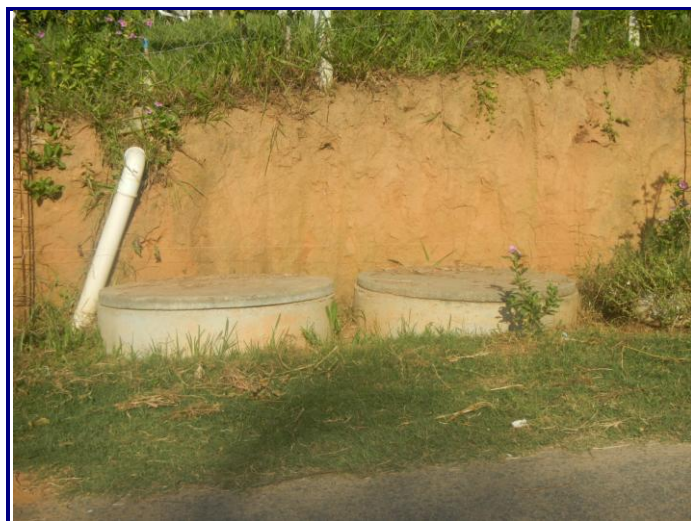
Foto 5.5.6-7: CONJUNTO FOSSA-SUMIDOURO PARA TRATAMENTO INDIVIDUAL DE ESGOTOS DOMÉSTICOS FONTE: ECOLOGUS, 2018.
