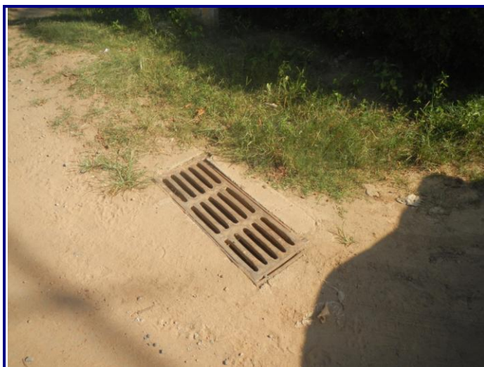
Foto 5.5.6-8: DISPOSITIVO DE DRENAGEM IDENTIFICADO NA ÁREA DO ATERRADO DO IMBURO FONTE: ECOLOGUS, 2018.
